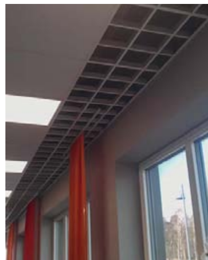
Undertaket närmast fasaden är öppet så att värme och kyla lagras i mellanbjälklaget.
